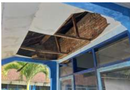
Gambar 2. Potret Kerusakan pada Atap dan Jendela
